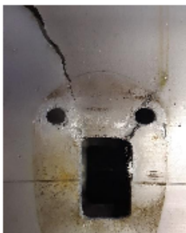
La découpe dans le mât pour les barres de flèche où on voit la corrosion, la fissure de fatigue et la défaillance finale.
