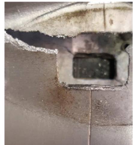
La découpe pour la barre de flèche montrant que la défaillance partit de l'angle
